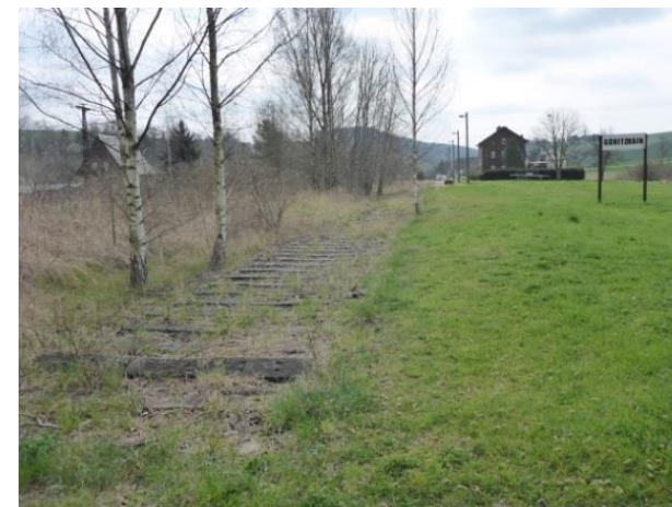
Foto 248: Göritzhein: Verschobene Schwellen am Bhf Göritzhein
