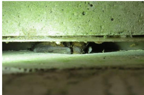
Foto 147: Abendsegler in Brückenbauwerk, vgl. Foto 146 und Foto 148 (Foto: C. Schmidt)
