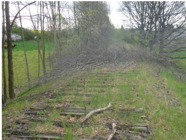
Foto 201: Kamenz: Bahnkörper mit verrotteten Holzschwellen
