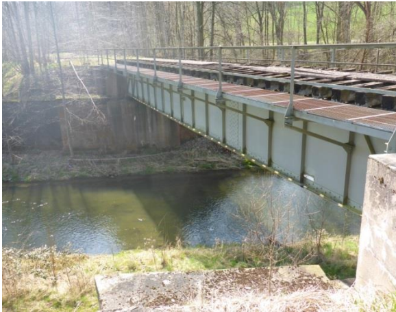
Foto 50: Sanierungsbedürftige Brücke als Teil einer stillgelegten Bahnstrecke – bauzeitliche Eingriffe in Uferbereiche möglich
