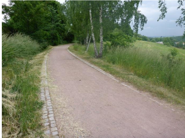
Foto 311: Freital, Am Birkenwäldchen: Umgesetzter Radweg in ungebundener Bauweise, seitlich mit Pflaster eingefasst
