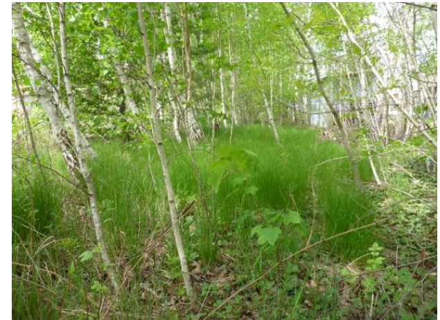
Foto 227: Pirna, Befehlsstellwerk Pirna-Rottwerndorf: Dichter Birkenaufwuchs auf dem Bahnkörper
