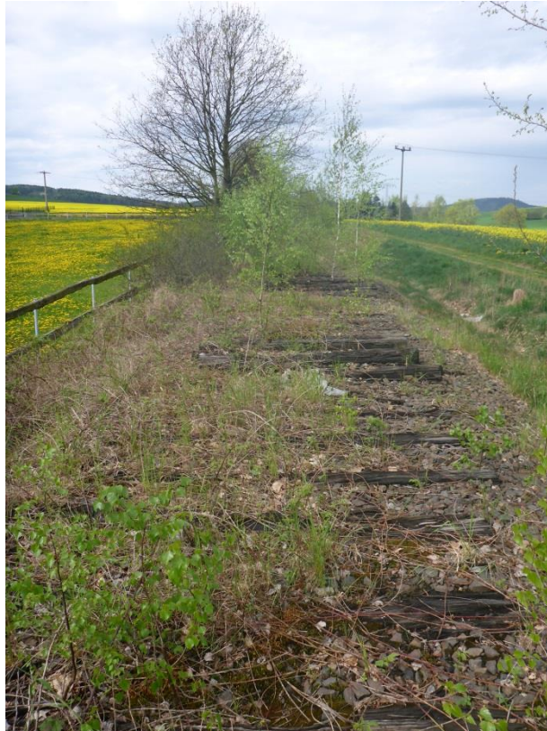
Foto 208: Wiesa: Beginnender Gehölzaufwuchs zwischen den Holzschwellen
