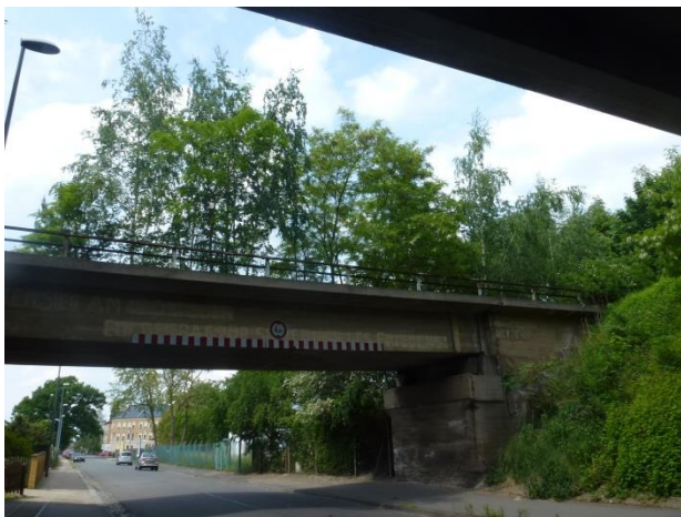
Foto 284: Dresden: Brücke über die Rankestraße ist mit hoch aufgewachsenen Pioniergehölzen bestockt
