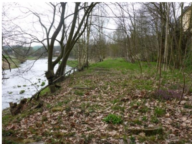
Foto 246: Göritzhein, Niedermühle: Verschobene Betonschwellen entlang der Chemnitz
