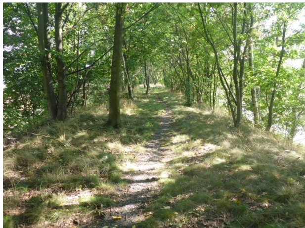
Foto 267: Theuma, Oelsnitzer Straße: Bahnkörper in Dammlage mit starkem Gehölzaufwuchs
