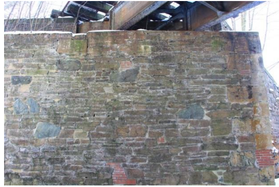
Foto 143: Widerlager mit offenen Fugen (Foto: C. Schmidt)
