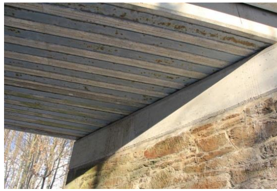
Foto 145: Widerlager mit Längsfuge (als Quartier geeignet) (Foto: C. Schmidt)
