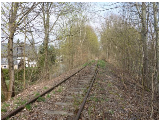
Foto 264: Chemnitz, Kopernikusstraße: Seitlicher Gehölzaufwuchs an Böschung des Bahndamms
