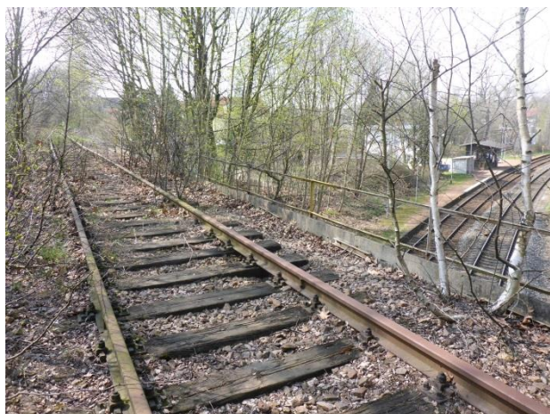
Foto 258: Chemnitz, Wittgensdorfer Straße: Überquerung noch in Betrieb stehender Bahnanlagen mit Gehölzaufwuchs auf Brücke
