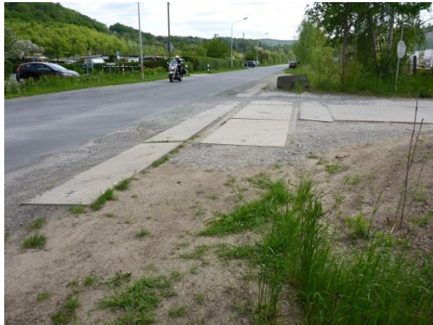
Foto 225: Pirna, Einmündung Schlegelweg: Gleise im Bereich einer Grundstückszufahrt
