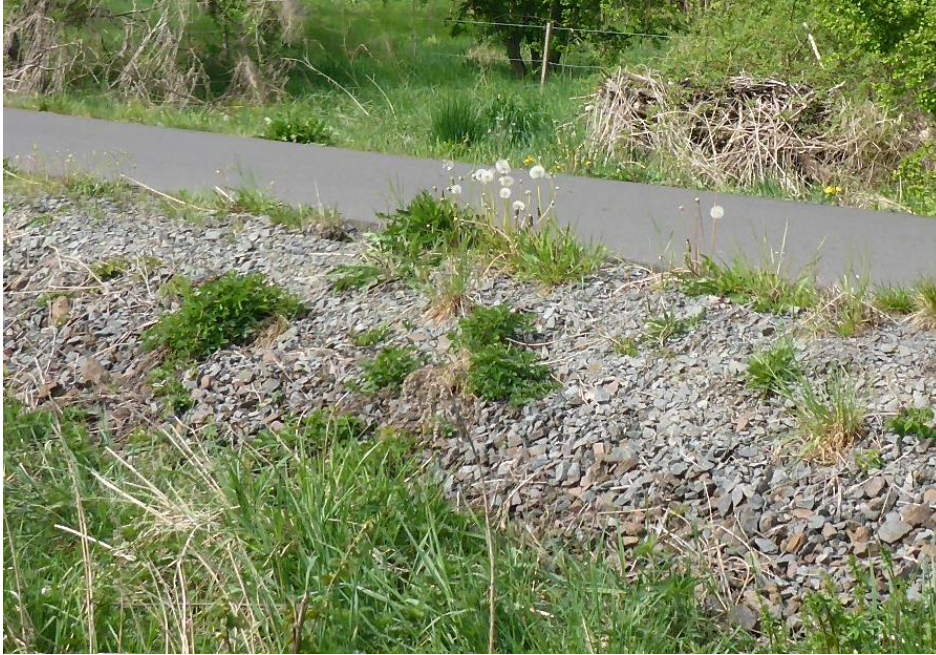
Foto 91: Radweg mit seitlich eingebrachtem Material aus Frostschuttschicht über dem roten Gleisschotter – UNGÜNSTIG, da vollständige Verdichtung der Hohlräume
