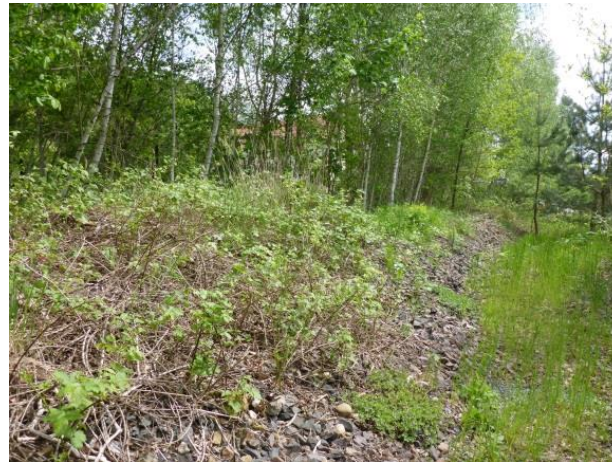
Foto 226: Pirna, Befehlsstellwerk Pirna-Rottwerndorf: Schotterkörper mit Brombeeren und Gehölzaufwuchs
