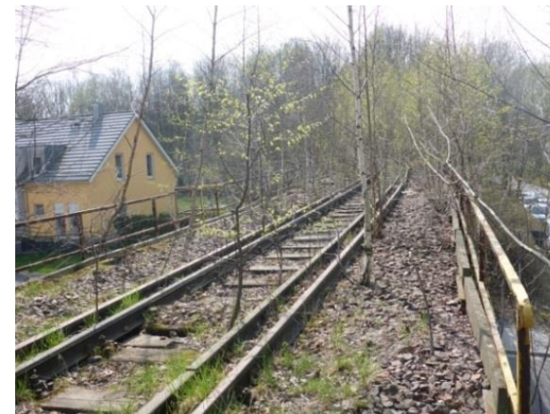
Foto 257: Chemnitz, Wittgensdorfer Straße: Gehölzaufwuchs auf der Straßenquerung über Wittgensdorfer Straße
