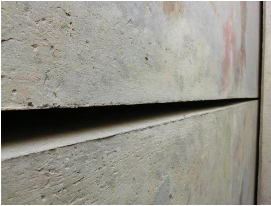
Foto 148: Widerlager mit offenen Fugen und Längsfuge im Brückenbauwerk (Foto: C. Schmidt)
