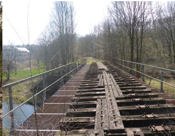
Foto 49: Sanierungsbedürftige Brücke – Teil einer stillgelegten Bahntrasse über ein Fließgewässer
