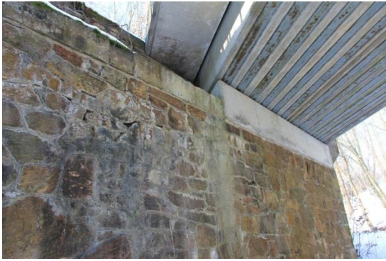
Foto 142: Widerlager mit offenen Fugen und Längsfuge im Brückenbauwerk (Foto: C. Schmidt)
