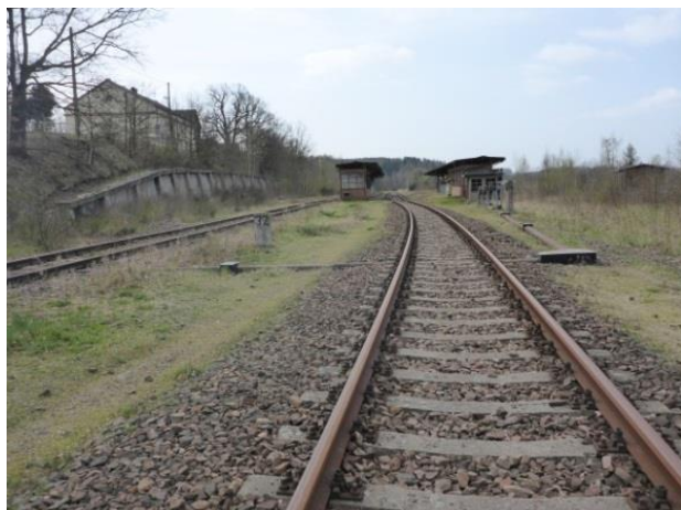
Foto 243: Wechselburg: Gleisanlagen am Bhf Wechselburg
